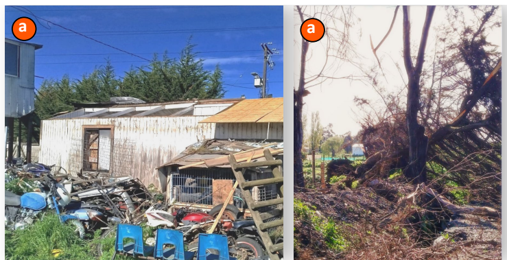
Figura 3. Trazado estimado para eventos de trombas/tornados registrados entre comunas de Hualpén y San Pedro de la Paz el día 20 de septiembre de 2025. Principales daños corresponden a voladuras de techos y caída de árboles. (a) Flechas indican sentido general de desplazamiento. Imágenes gentileza de Departamento de Gestión del Riesgo de la Municipalidad de San Pedro de la Paz.
